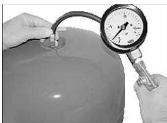
Рис. 6 Контроль давления в мембранном баке
